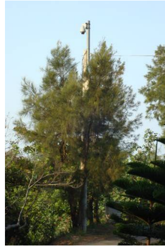
照片44 野外即時影像監視系統一
