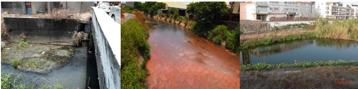
舊鹿港溪河道淤積
