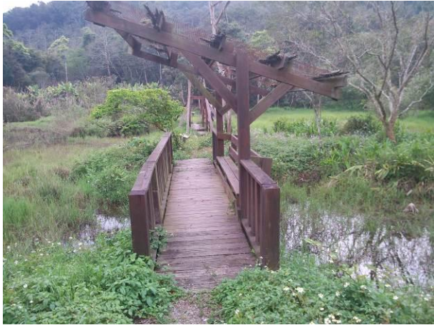
a. 開放區設施損壞
