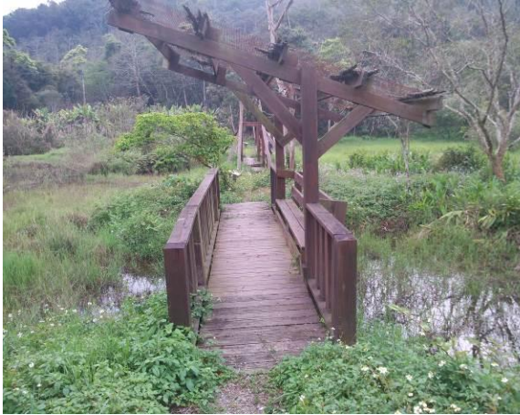
a. 開放區設施損壞
