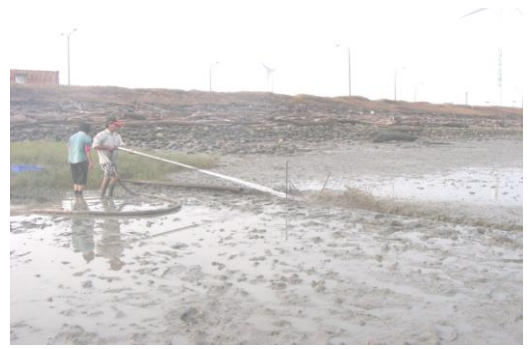
▲抽水機之強力水柱可以在沒有污染的情況下，將互花米草之根系完整清除。
