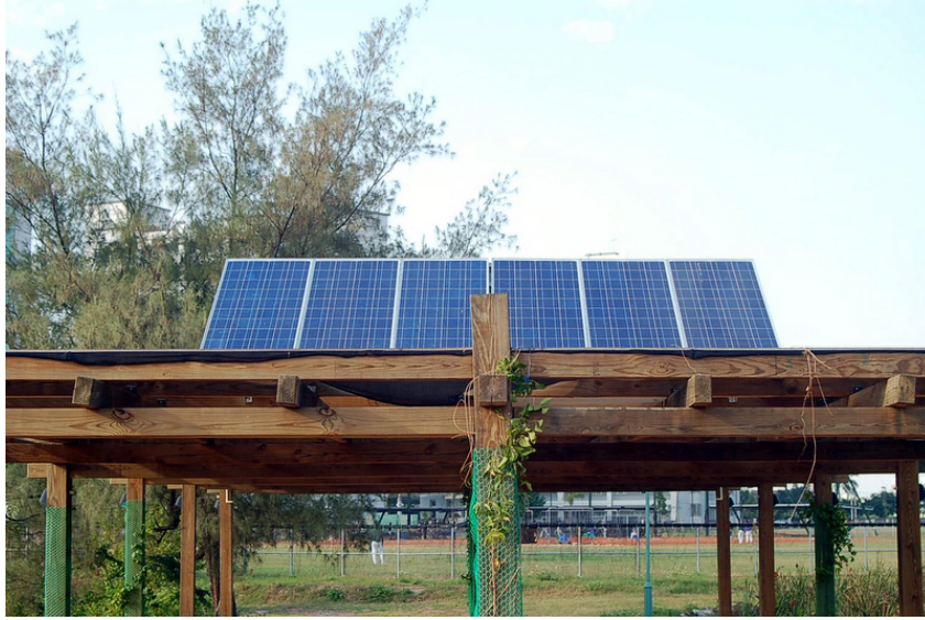
圖 11 太陽能光電設備：每年可產生約 500 kWh 的電量，足以提供園區內必要夜間照明。
