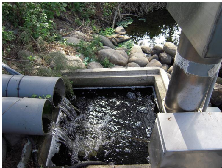
圖 8 FWS 濕地出口：人工濕地淨化後的清澈水由此處流至生態池，右方為流量及水質即時監測設備。
