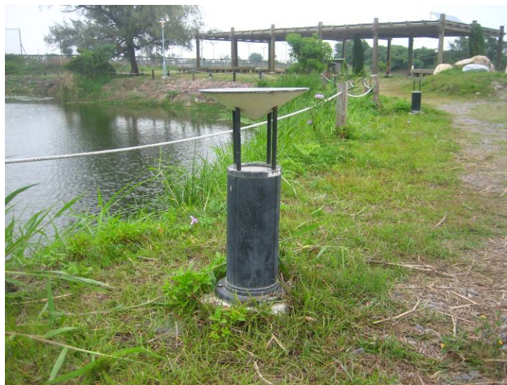
圖 12 人工濕地場址內的夜間照明由太陽能提供。
