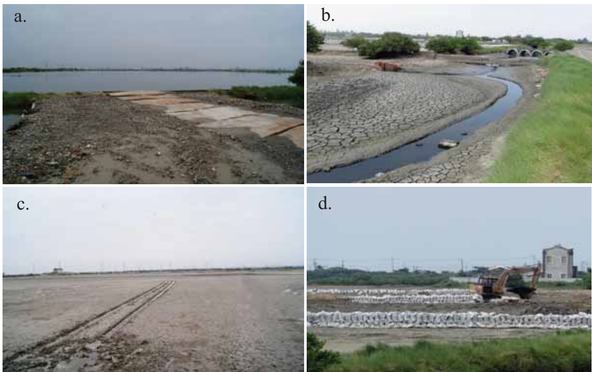
圖 15、濕地內樣區 7 施工情形。a. 填補溝渠鋪設鐵板，造成水流截斷。b. 截斷後的水流乾涸 c. 挖土機的胎痕 d. 挖土機開入樣區 7 內進行沙包填補。
