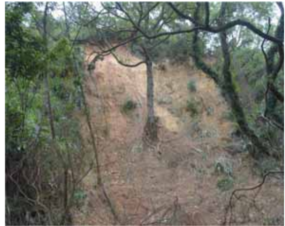
6月12日北坡崩塌的情形
